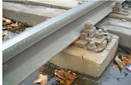
Carolabrücke Schadhafes Schienenaufleger
